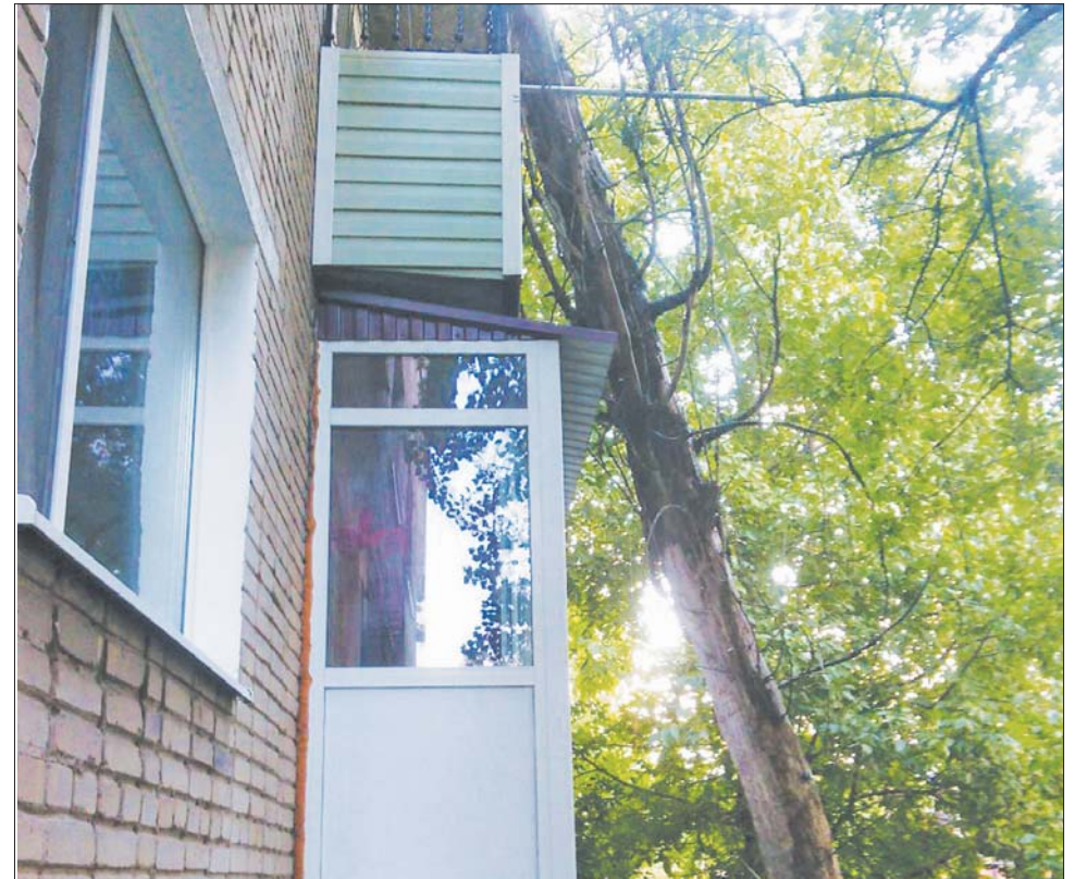
Ствол-исполин повредил балкон второго этажа на ул. Темерницкой. Фото прислали в редакционный WhatsApp.
