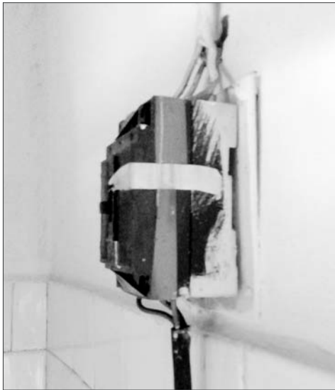
Электрический щит заклеен малярным скотчем.
