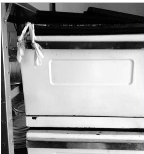
Дверца духового шкафа перевязана тряпкой, иначе она не держится.
