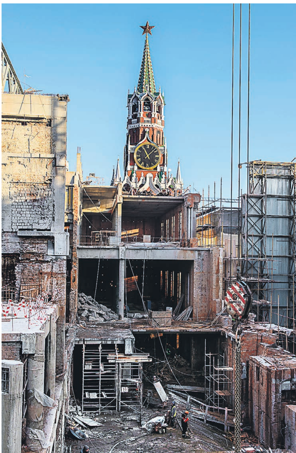
Спасская башня теперь вырастает прямо из руин 14-го корпуса Кремля ФОТО ДМИТРИЯ АЗАРОВА
