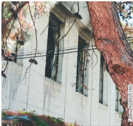
С обратной стороны здания видны выбитые окна.
