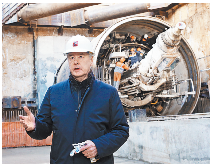
Мэр Москвы Сергей Собянин осмотрел стройку Большой кольцевой линии в районе Зюзино, где появятся три новые станции.
