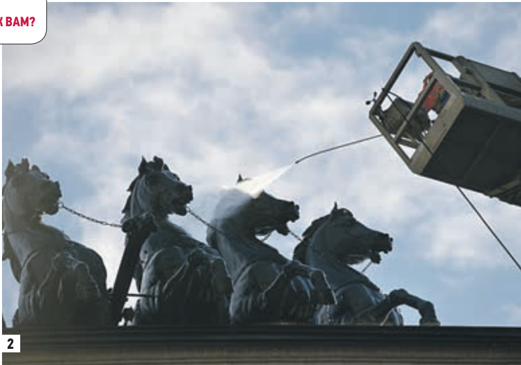
Вчера 13:30 Мастер участка Виталий Детушев следит за ходом работ по очистке объекта культурного наследия (1) Триумфальную арку моют раз в три недели (2)
