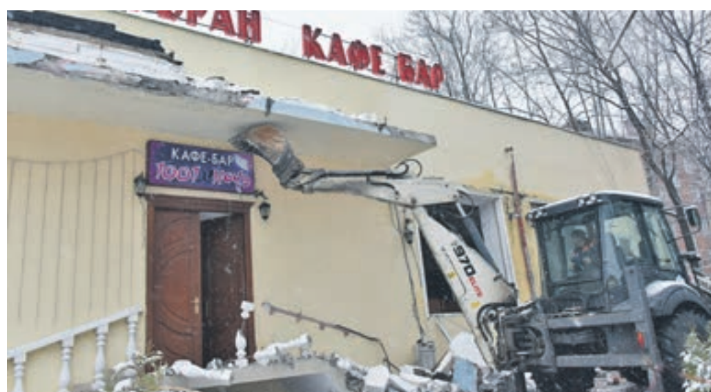
24 ноября 10:07 Сотрудники ГБУ «Автомобильные дороги» начинают снос здания кафе, расположенного по адресу: Линейный пр-д, 3, стр. 1. Под ковшом трактора долго эта вывеска не выдержит...
