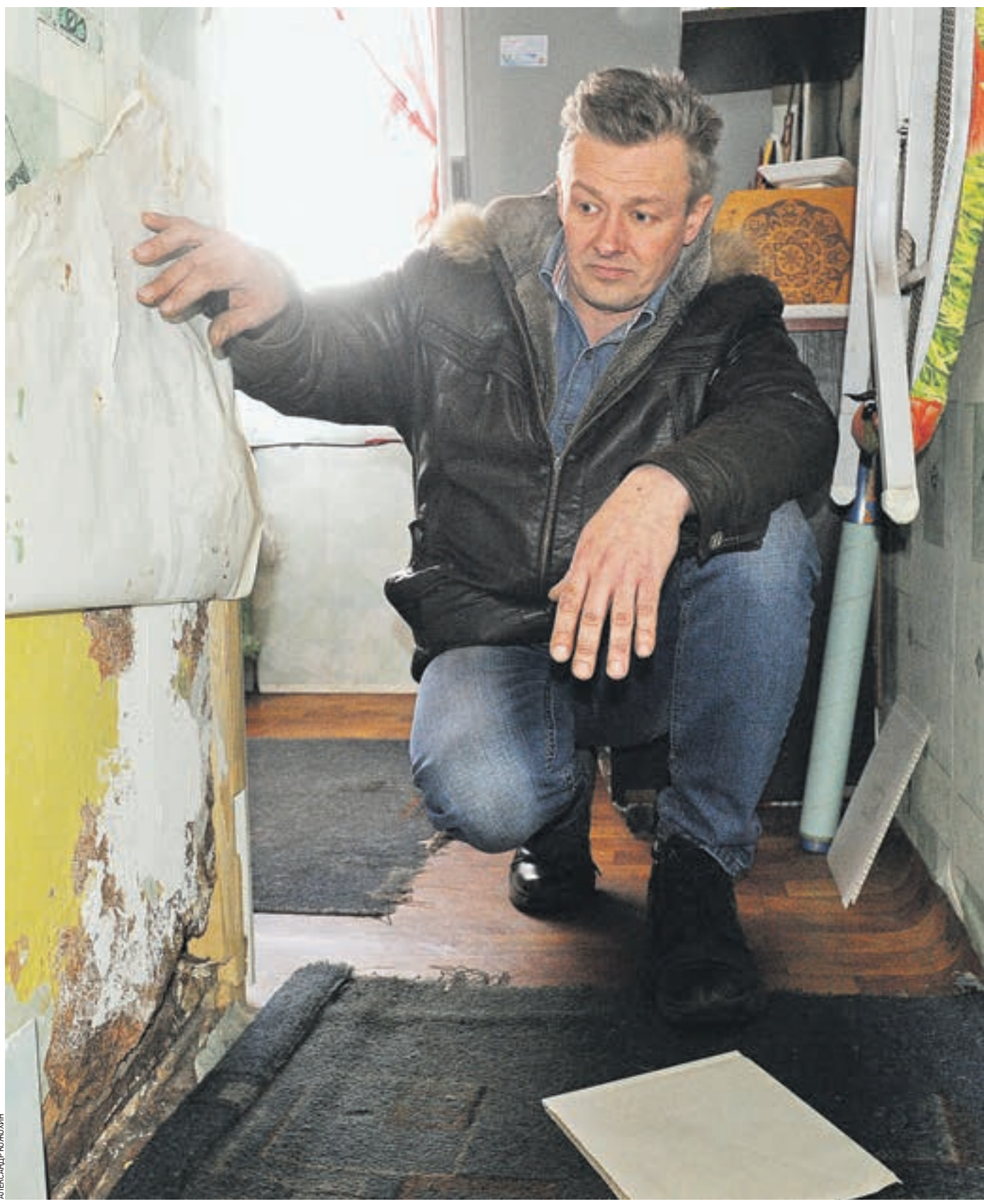
13 марта 15:31 Житель пятиэтажки в районе Кузьминки Геннадий Екимов. В квартире на первом этаже мужчина пережил 17 лет назад. Со временем дом обветшал, а одна из стен из тонкой струганной плиты прогнила. Его жильцу пришлось поменять
