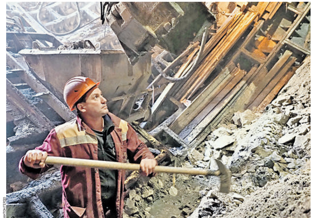
10 мая 2018 года 13:39 Проходчик Гочи Циколия работает на станции «Шереметьевская». Стройку ведут на глубине свыше 70 метров
