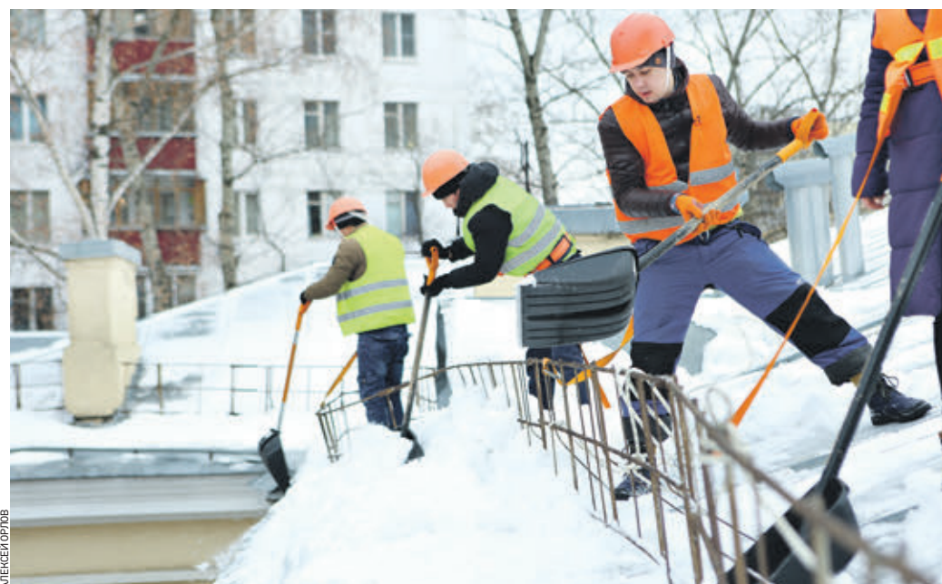
19 января 13:02 Сотрудники ГБУ «Жилищник района Ростокино» расчищают от снега крышу дома № 16 по улице Бажова. На переднем плане — рабочий Николай Рябчевский
