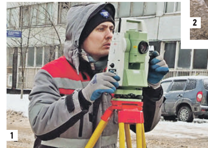
19 января 2019 года 12:00 Специалист проводит геодезическую съемку на месте провала грунта (1) Проблемный участок дороги на Ферганской улице (2)
