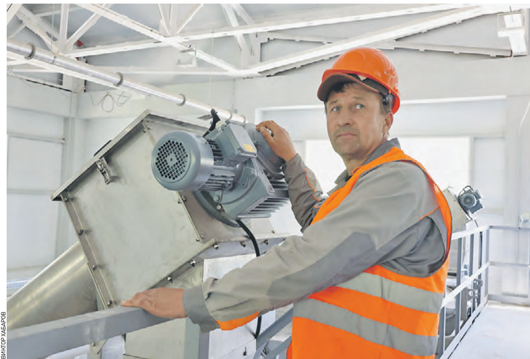
Вчера 11:34 Начальник строительной бригады Александр Федоров проверяет исправность работы систем механической очистки сточных вод
