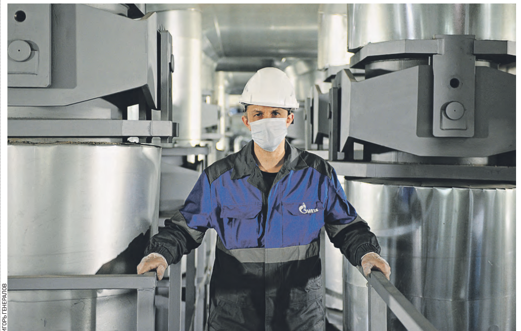
Вчера 13:06 Работник насосно-перекачивающей станции «Бирюлево-Борисовская» ПАО «МОЭК» Михаил Пеннин во время сильных морозов контролирует работу оборудования
