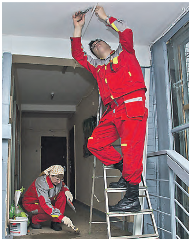
Ремонт в домах бывает косметическим, текущим и капитальным, и собственникам жилья полезно знать об отличиях между ними
